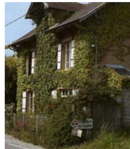
Abb. 47: Efeubewuchs an Pisé-Fassade
